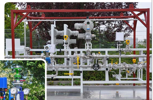
Pumpanlagen für die Wasserwirtschaft
